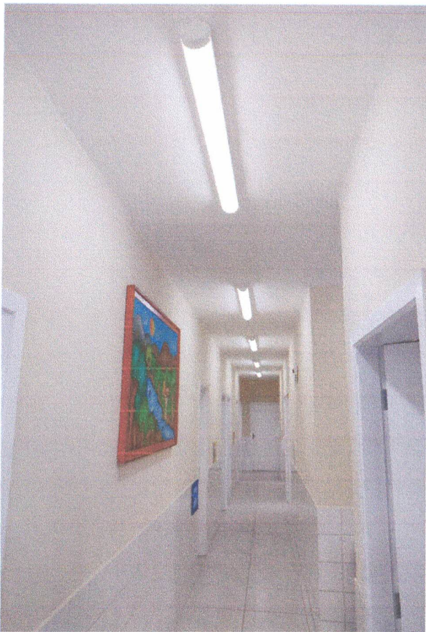
VISTA GERAL ILUMINAÇÃO
