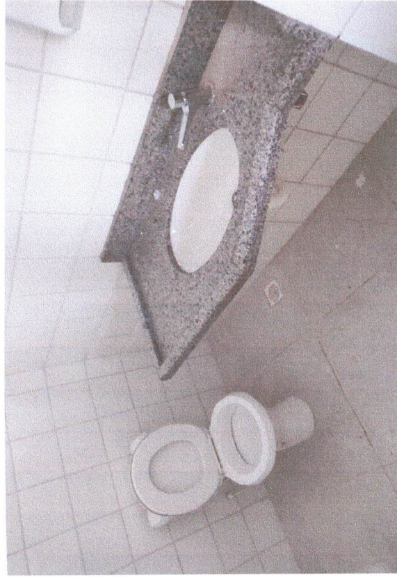
BANCADAS COM CUBAS / TORNEIRA E SIFÃO
