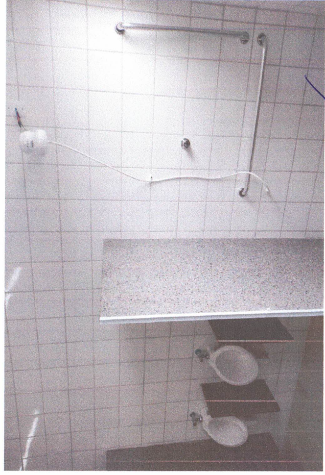
BARRAS DE APOIO PNE E CHUVEIRO
